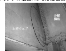
亀裂発生状況
